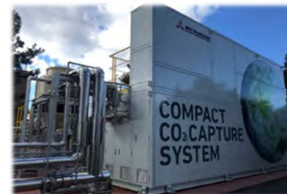
焼却工場のCO 2 回収の実証試験
